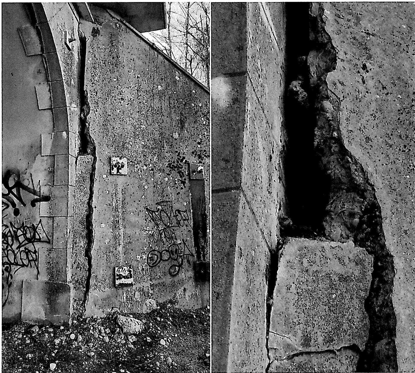
FOTO 1: lesione centimetrica del muro d'ala Nord – lato Venezia.
